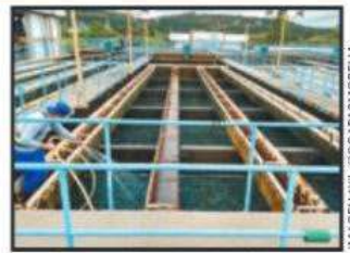
La planta potabilizadora de La Mintzta ya funciona al total de su capacidad.
